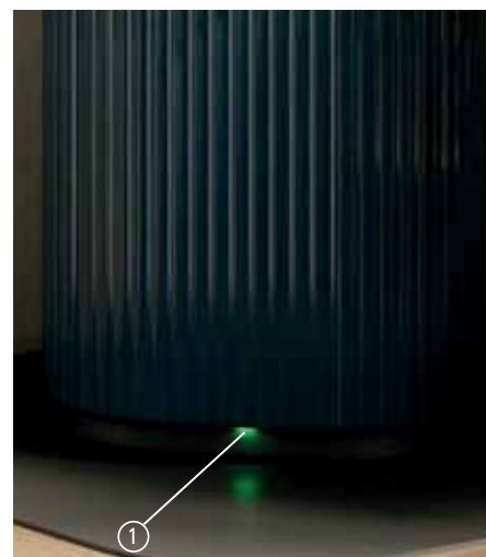
Abb. 4.23 LED-Lichtsignal der elektronischen Heizhilfe auf dem Fußboden vor dem Speicherofen 1)
